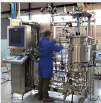
REMISE A NIVEAU D'INSTRUMENTATION ET D'AUTOMATISME
